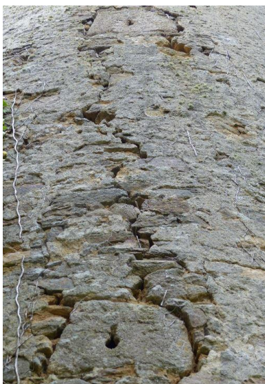
Fig. 51. Montautre, tour SO, l'une des nombreuses fissures [cl. ChR 2021].
