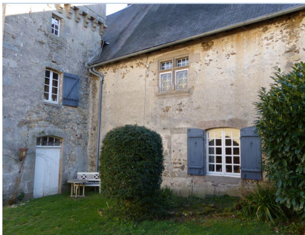
Fig. 23. Montautre, logis oriental, façade O côté cour et amorce du pavillon du grand degré [cl. Chr. Rémy, 2020].
